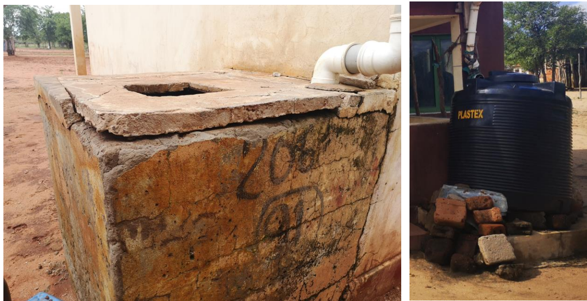
Figura 6: Tanques a betão em uso na comunidade de Macavene. (Fotografia: Issufo Tankar)
