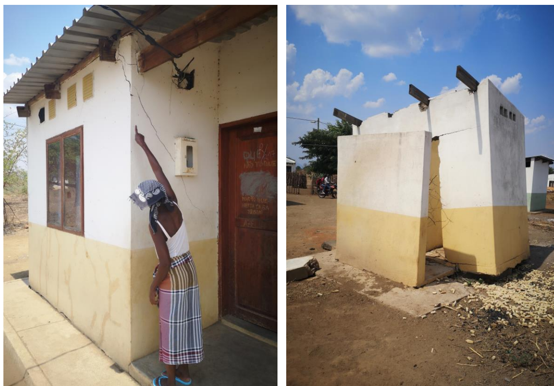
Figura 10: Evidências de má qualidade na construção em Cateme. (Fotografia: Issufo Tankar)
